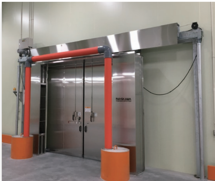
冷蔵庫前設置パターン
