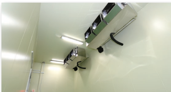
蓄冷材凍結庫
