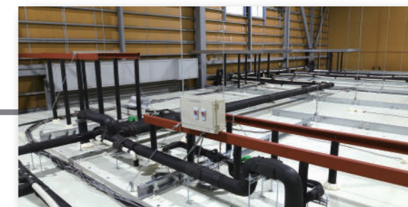
天井裏配管設備
