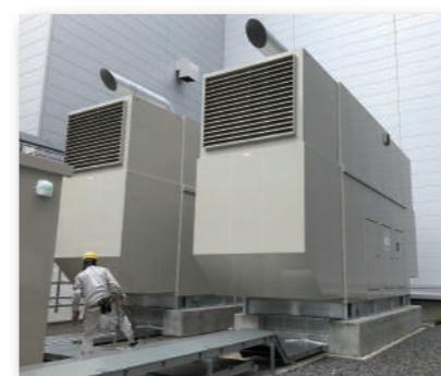
非常用発電機
