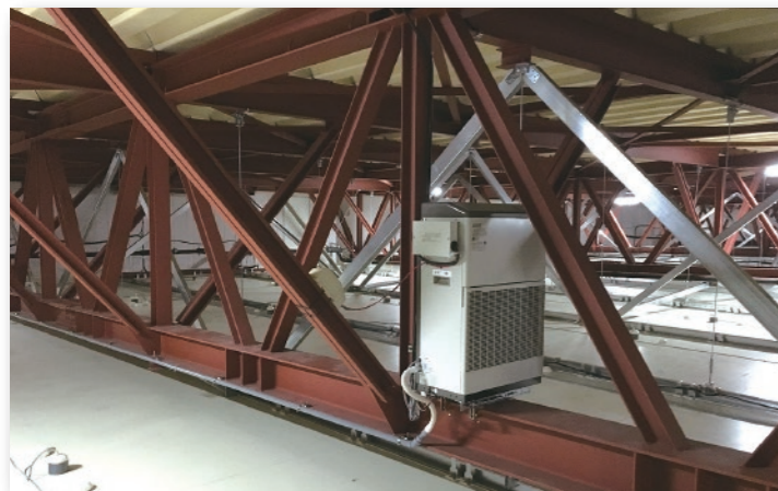
除湿機設置状況
