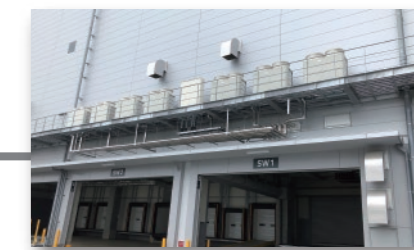
設備用インバーターエアコン室外機
