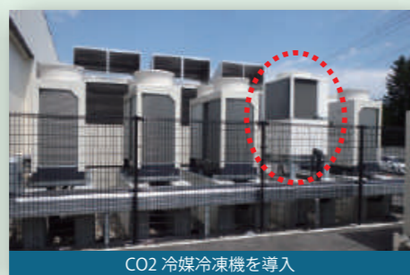
CO2 冷媒冷凍機を導入
