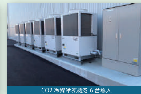
CO2 冷媒冷凍機を 6 台導入
