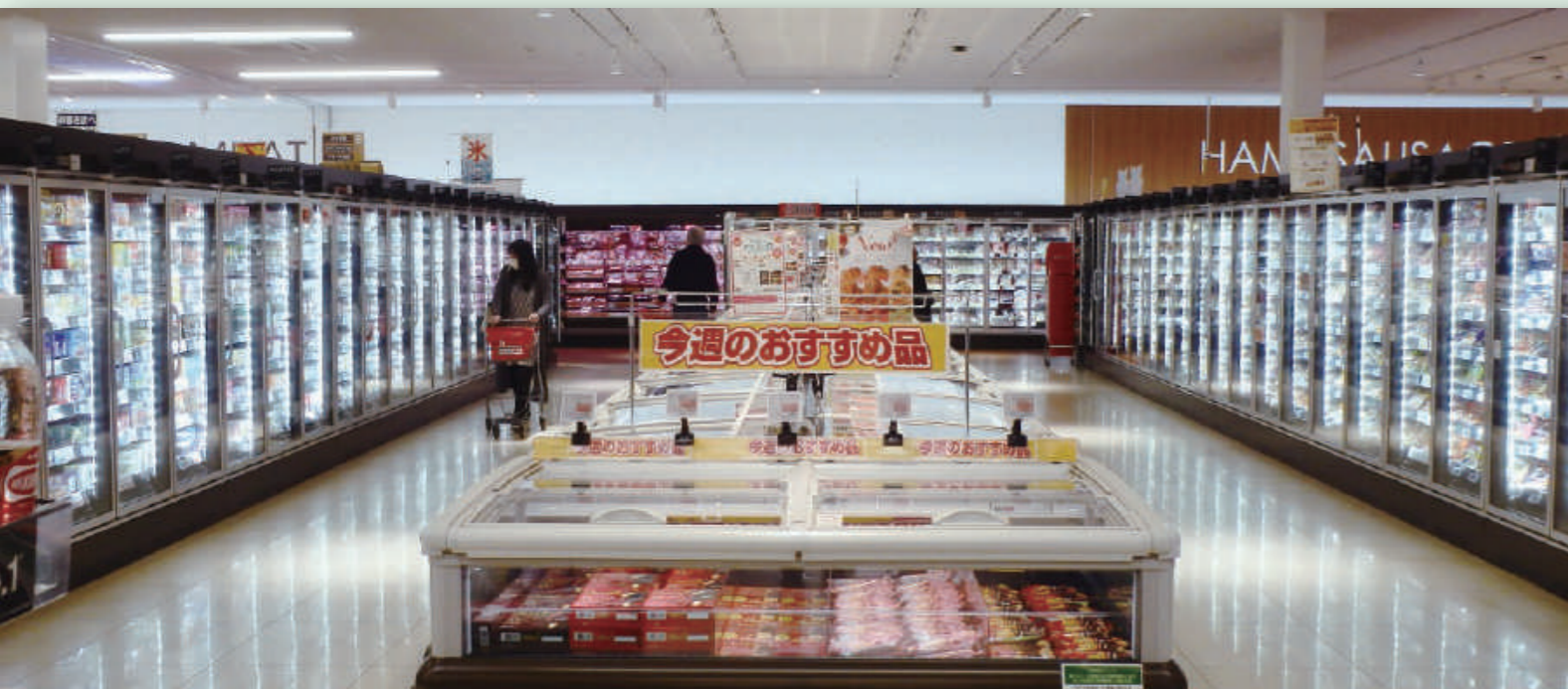
フローズンコーナーのショーケースは CO2 冷媒用のショーケースを設置
