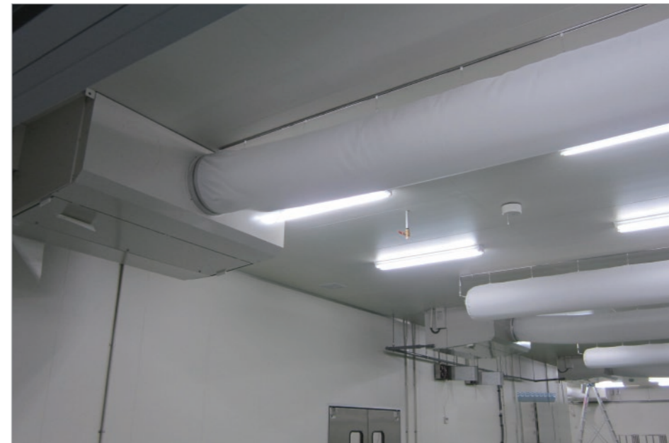
▲ソックダクト
