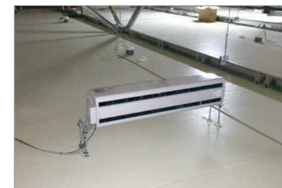
◀エア-搬送ファン▶ 滞留した空気を循環させます
