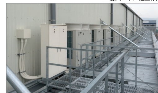
▲インバータ冷凍機
